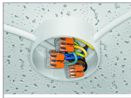
Distribution d'éclairage dans les plafonniers
